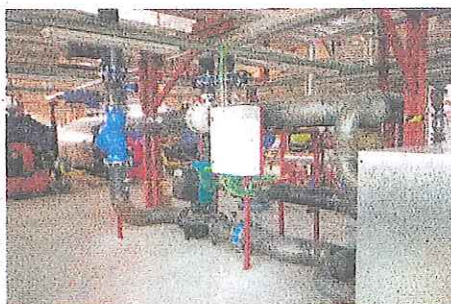
Sala de calderas.
